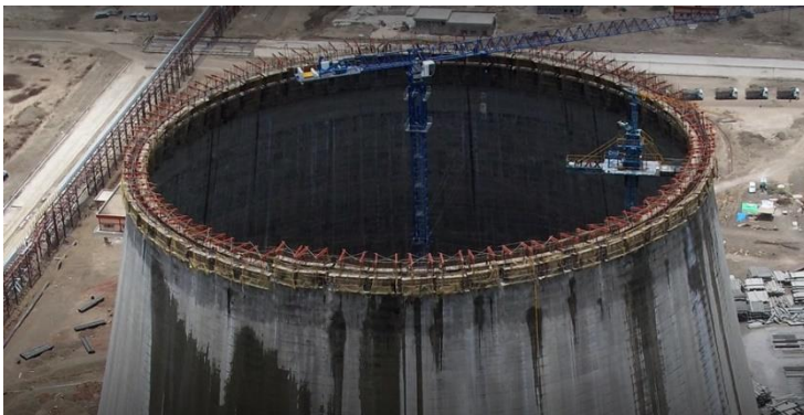
Ilustración 6: Central térmica de Kalisindh, en La India
