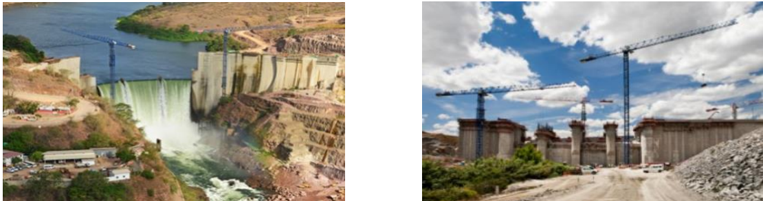
Ilustración 3: Grúas COMANSA en la construcción de las presas de Baixo Sabor en Portugal (IZDA) o Cambambe en Angola (DCHA)
